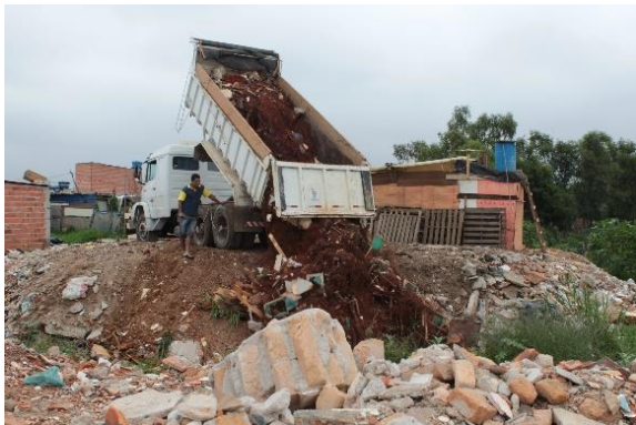
Foto 07: Despejo ilegal de entulho
