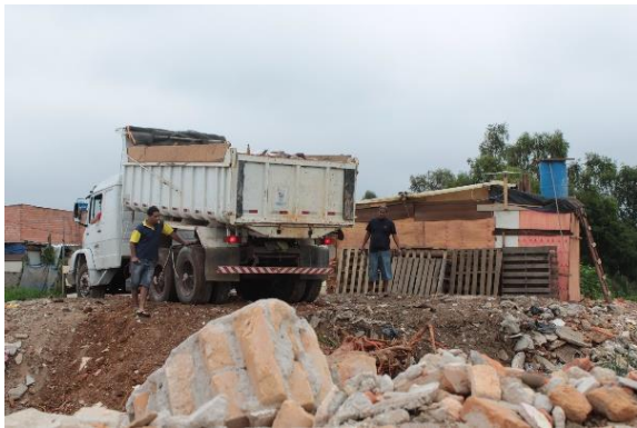
Foto 05: Despejo ilegal de entulho
