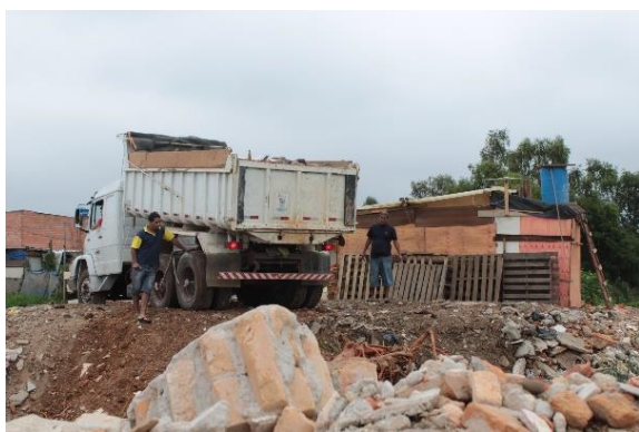
Foto 05: Despejo ilegal de entulho
